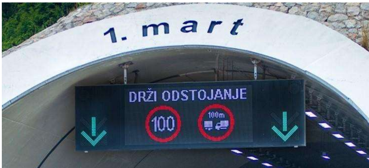
Sl.3 – Displej na stropu tunela
